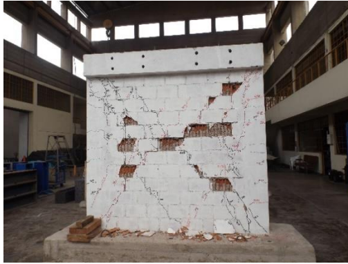
Figura – 20: Estado final del muro para una distorsión 1/200. Fuente: Ensayo de carga cíclica de tres muros escala natural. 2016
