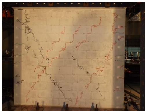
Figura – 19: Aparición de más grietas diagonales en el muro para la distorsión 1/400
