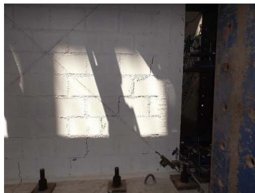
Figura – 27: Formación de grietas diagonales en el mortero hasta antes de la parte central en la parte inferior Oeste de la cara Norte para una distorsión 1/1500.
