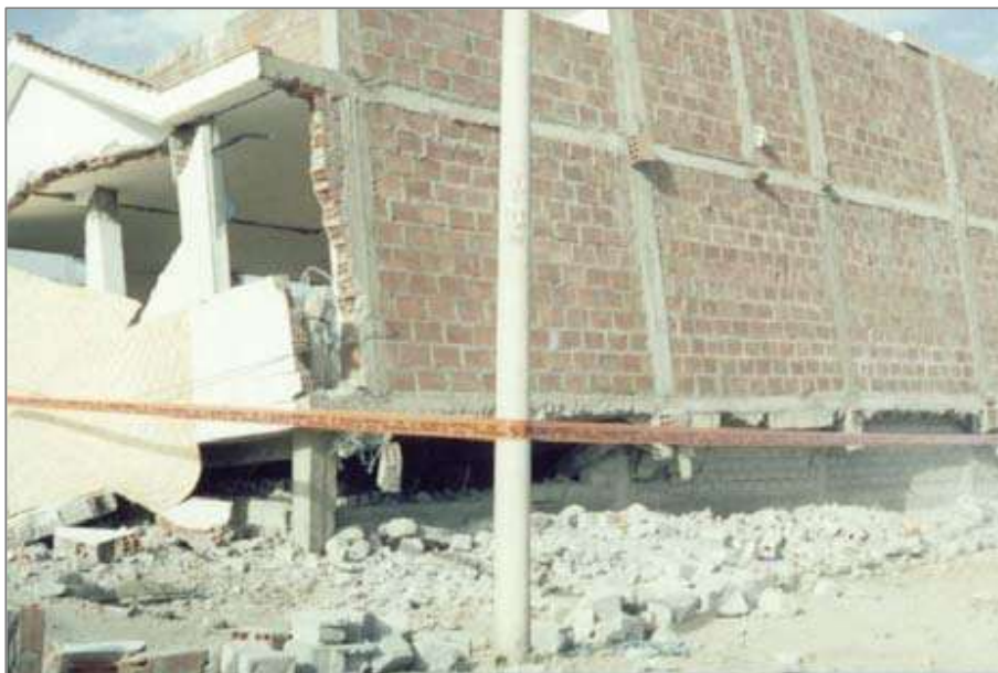
Figura 2. Colapso de vivienda debido al sismo del 23 de junio del año 2001 en Tacna
