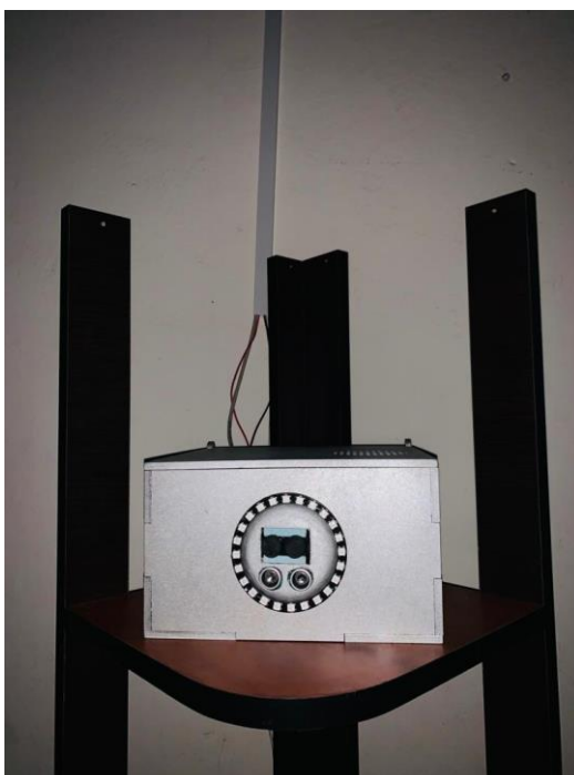
Equipo biométrico instalado al exterior del área – vista 1
