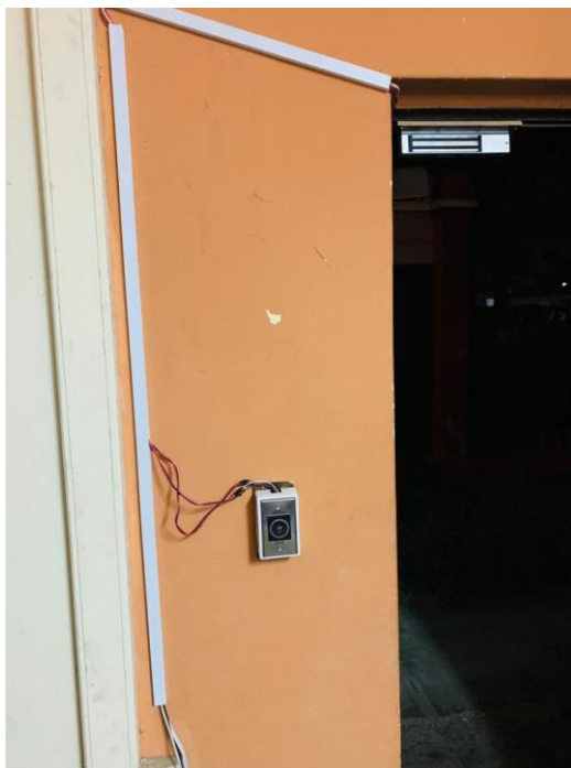
Electroimán y botón no touch instalados
