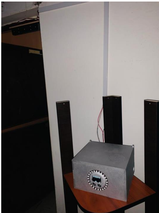
Equipo biométrico instalado al exterior del área – vista 2
