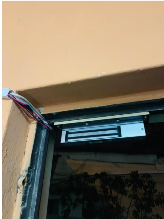
Electroimán colocado en la puerta de acceso
