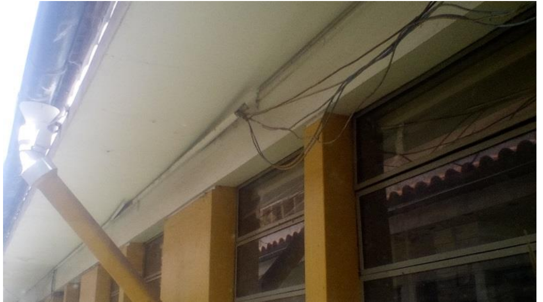
Figura 33: Parte lateral de Farmacia, cableado expuesto sin protección
