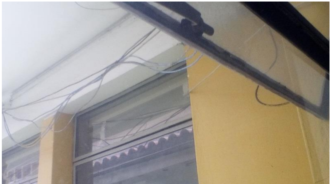
Figura 32: Parte lateral de Farmacia, cableado expuesto sin protección
