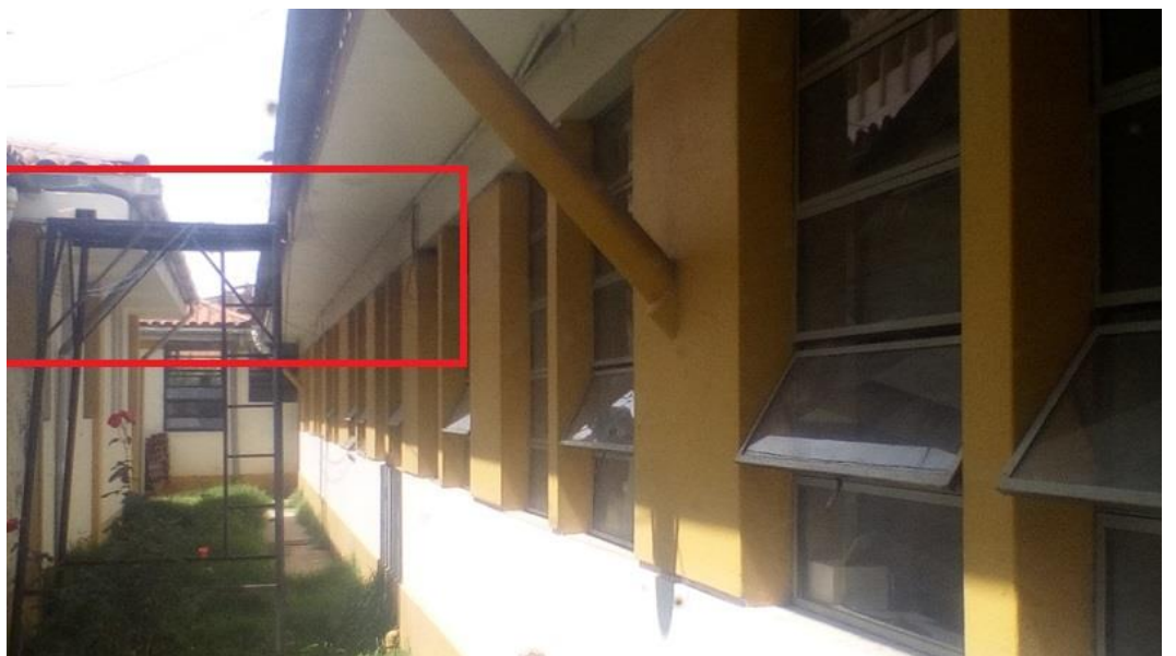
Figura 34: Cable expuesto colocado con protección para conectividad entre oficinas
