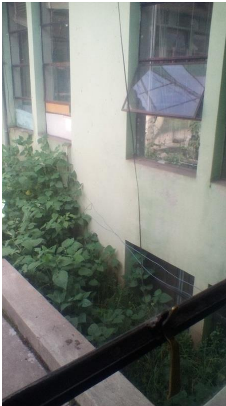
Figura 26: El cableado se encuentra expuesto al medio ambiente
