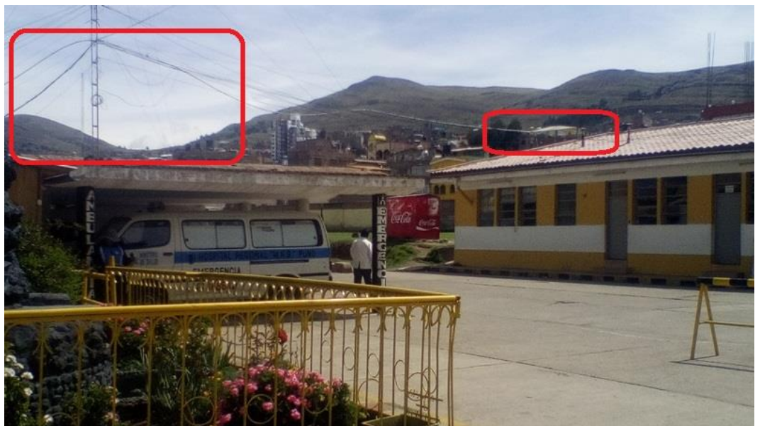
Figura 36: Tuberías de PVC que distribuyen el cableado hacia las oficinas de otra edificación con un cable que no es para uso externo
