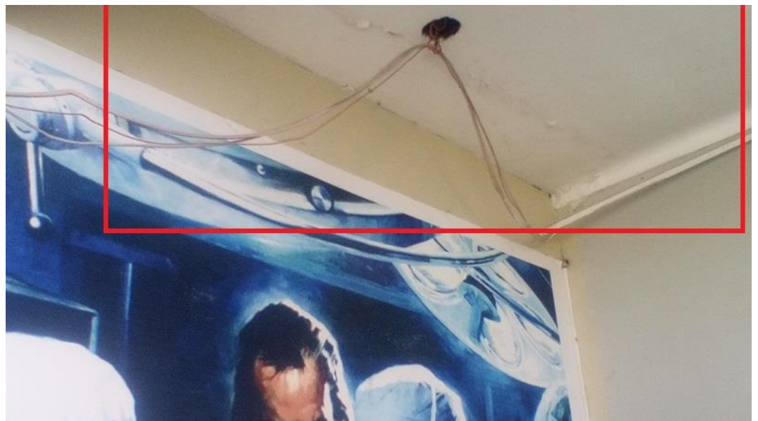
Figura 30: Cable Utp sujetado con cable eléctrico, ocasionando diafonía en el paso de datos.
