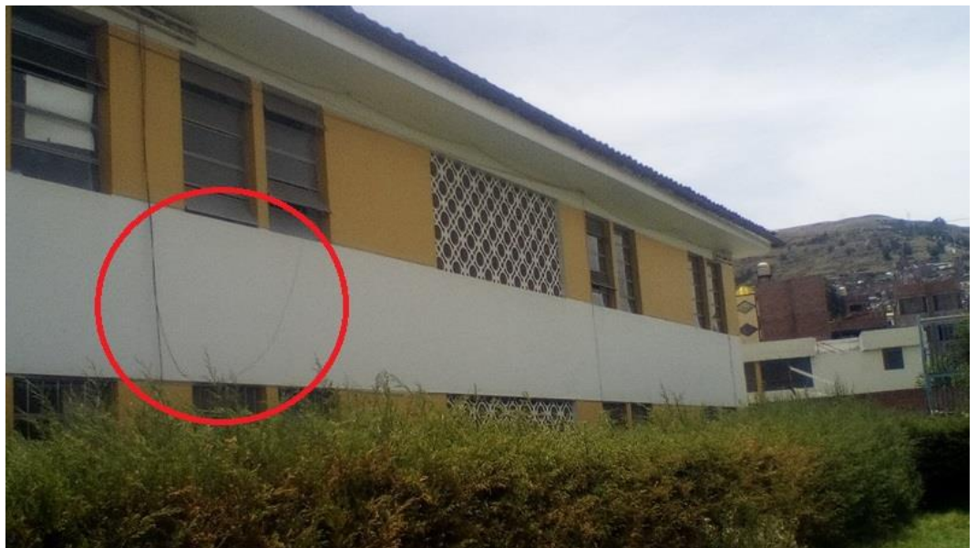
Figura 31: Oficinas Administrativas, cable expuesto para conectividad entre oficinas
