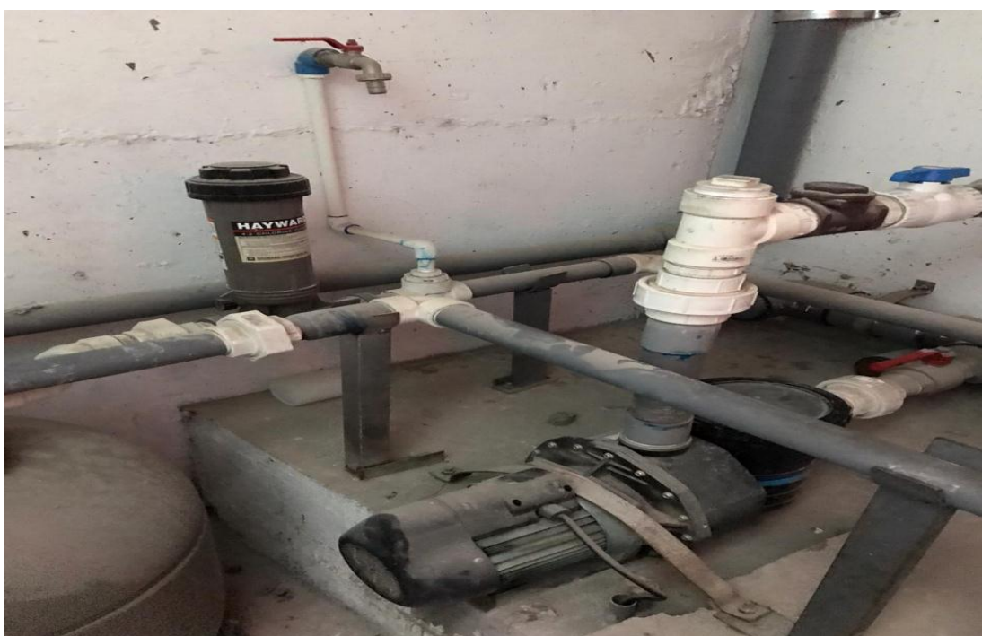
Figura 22. Casa de Maquinas Sistema de Tratamiento de agua de Piscina Baños turcos Adán y Eva, Febrero 2020
