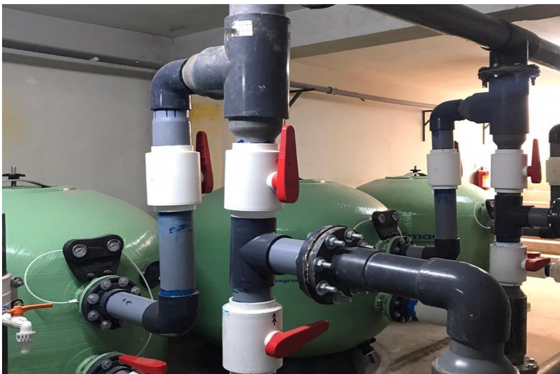
Figura 26. Casa de Máquinas Sistema de Tratamiento de Piscina Olímpica Gino Chiarella, Febrero del 2020
