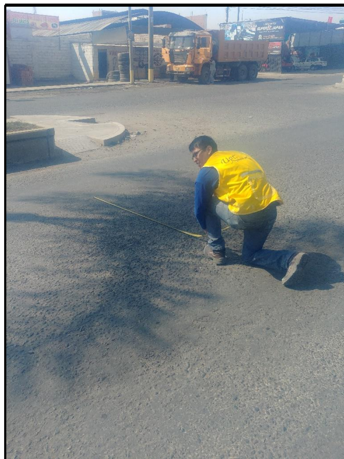
Medición falla piel de cocodrilo
