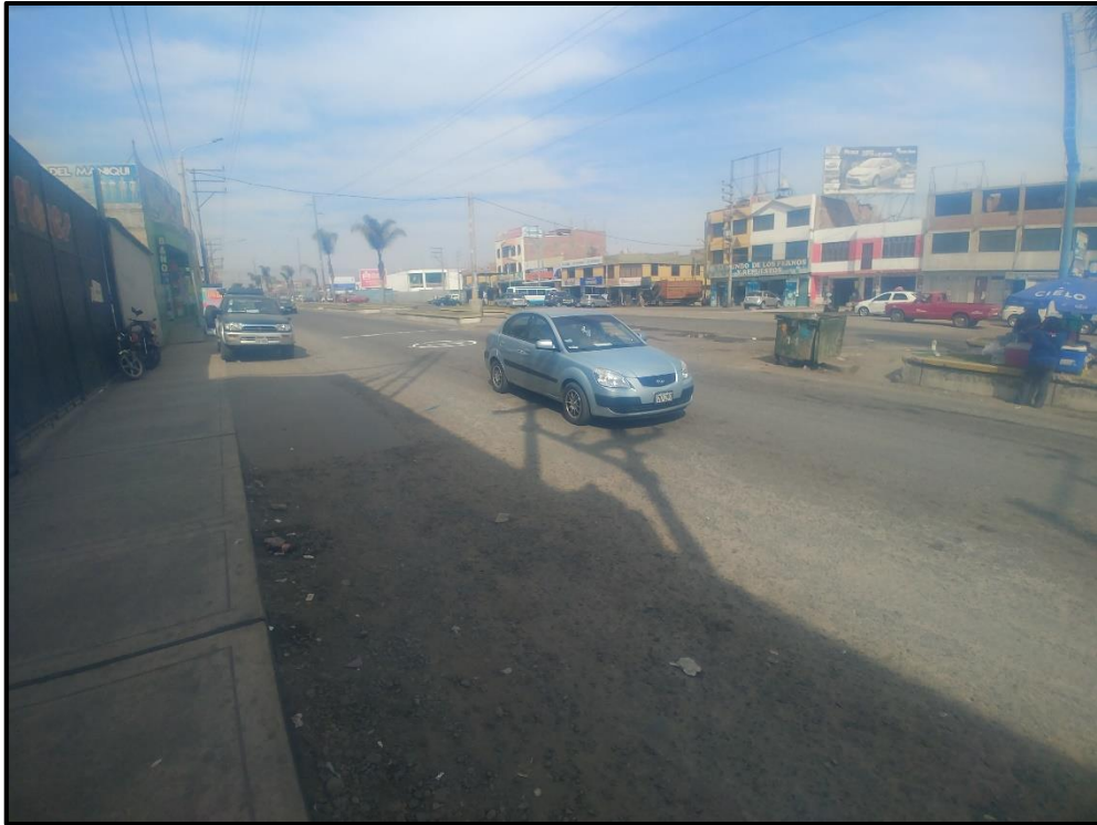
Desprendimiento de agregados
