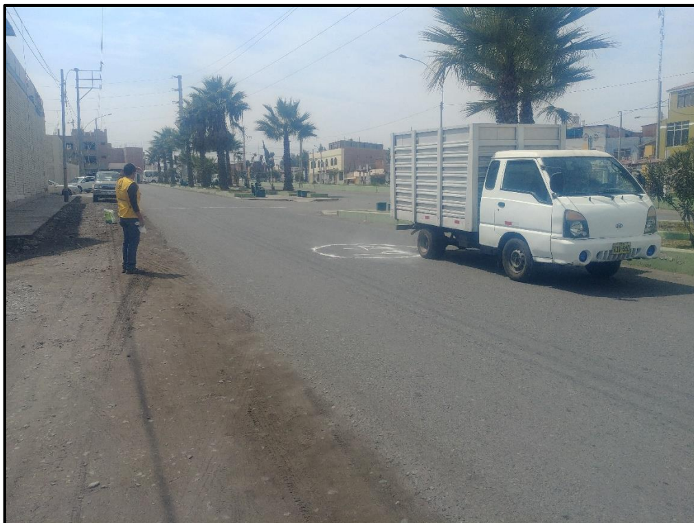
Evaluación de muestra N° 13 calzada de bajada
