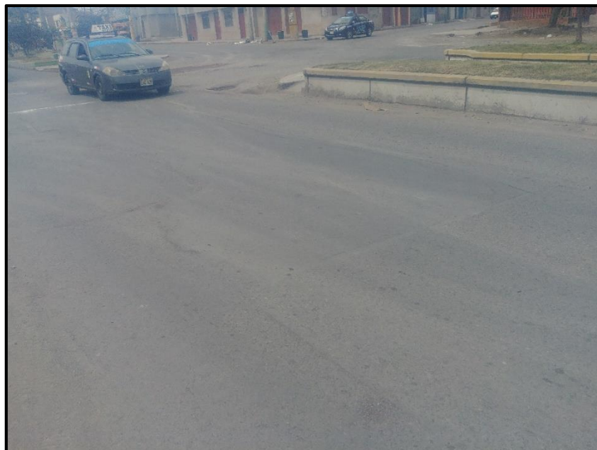
Grietas parabólicas, longitudinales y transversales
