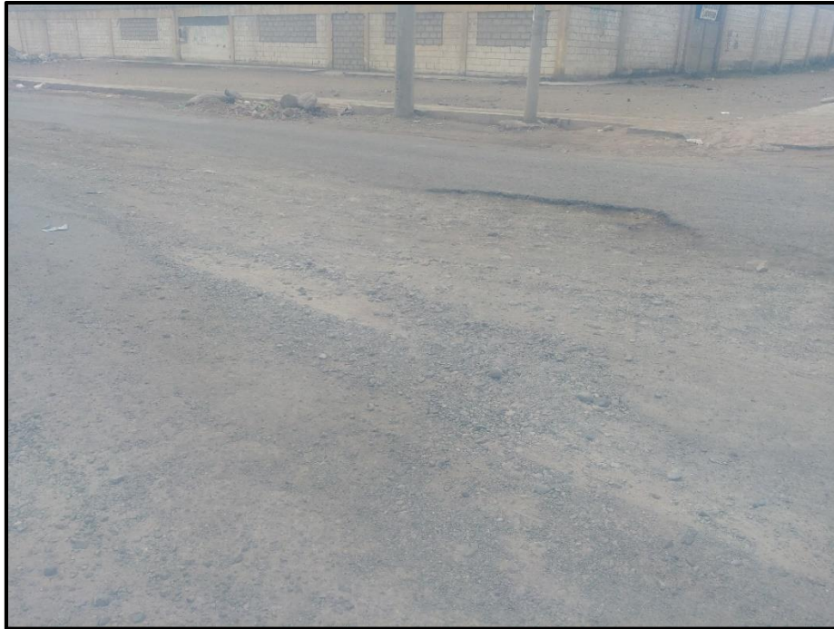
Desprendimiento de agregados y hueco
