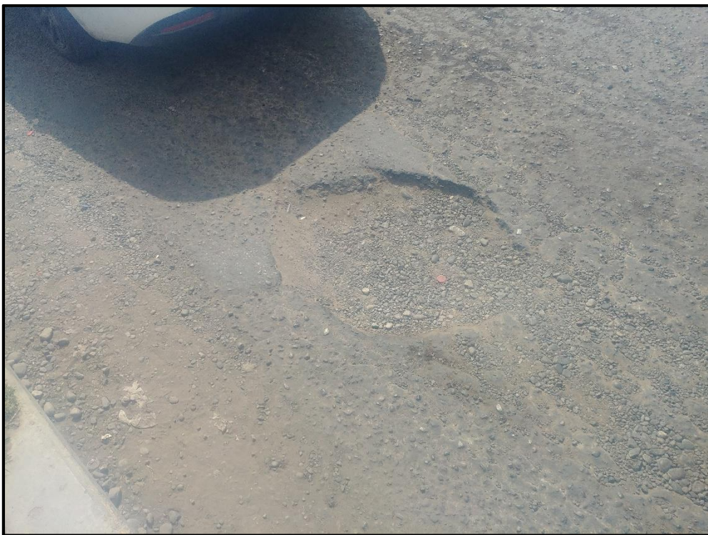
Desprendimiento de agregados y hueco
