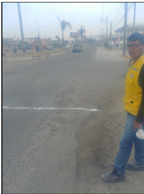
Desprendimiento de agregados y piel de cocodrilo
