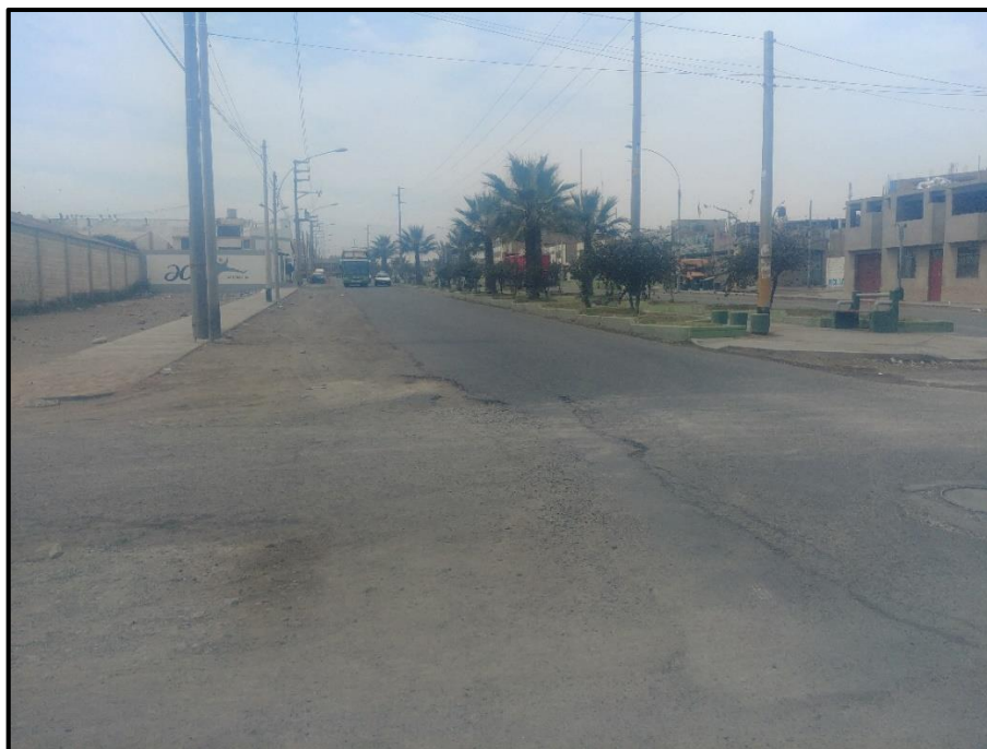
Desnivel carril berma, hueco, desprendimiento de agregados y grietas
