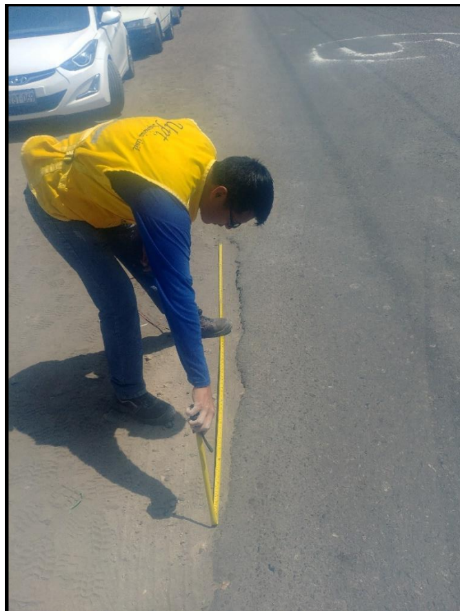
Medición desnivel carril berma
