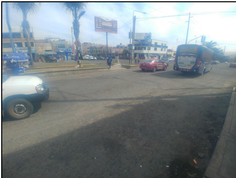
Desprendimiento de agregados
