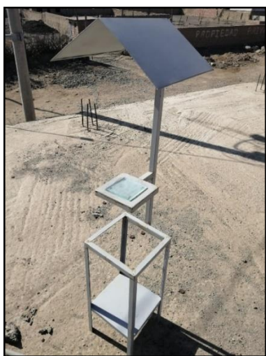
Figura 9 Caseta metálica y placa petri instalada adecuadamente.
