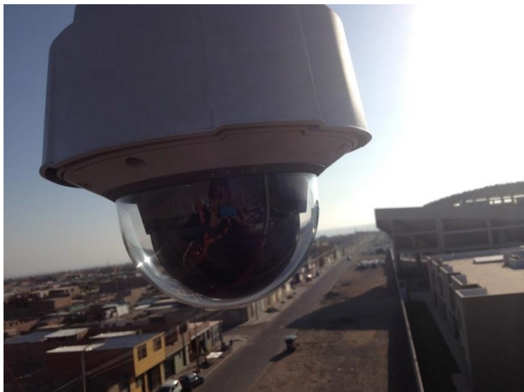
Figura 29: Cámara Axis Instalada para el sistema de videovigilancia de Coronel Gregorio Albarracín Lanchipa Fuente: Informe de Mantenimiento de Cámaras de Videovigilancia del distrito
